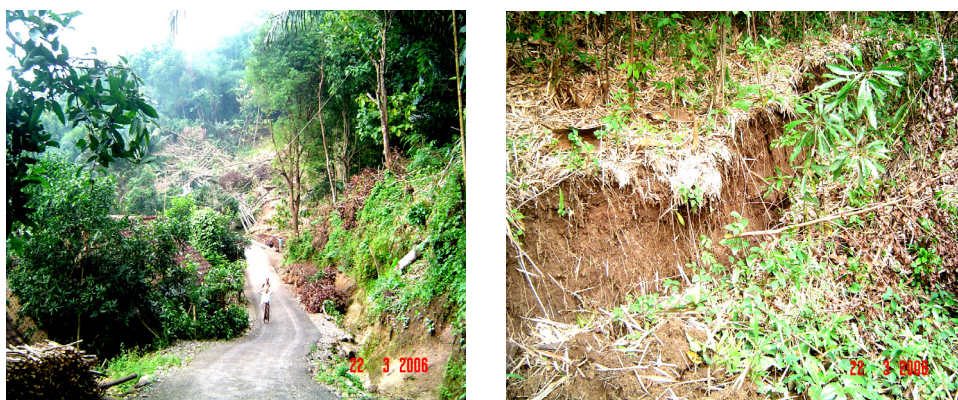
Gambar 8. Gejala tanah longsor yang terjadi pada lereng di atas jalan, jika kondisi ini terus berkembang, akan mengancam perumahan di Blok Tarikolot, Desa Sidamukti, Kec/ Kab. Majalengka (keadaan pada Februari 2006)
